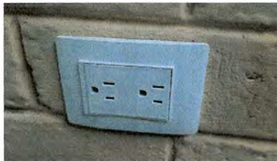
Foto 10: sistema eléctrico instalado
