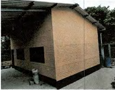
Foto 1: levngtamiento de paredes en mojinete pintadas
